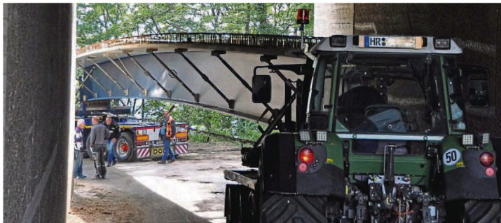
Landwirte helfen mit Schleppern: Aber es nutzte alles nichts, die Brückenteile passten nicht durch die Unterführung der A 7 bei Guxhagen-Ellenberg. FOTO: ROLF FÄRBER
